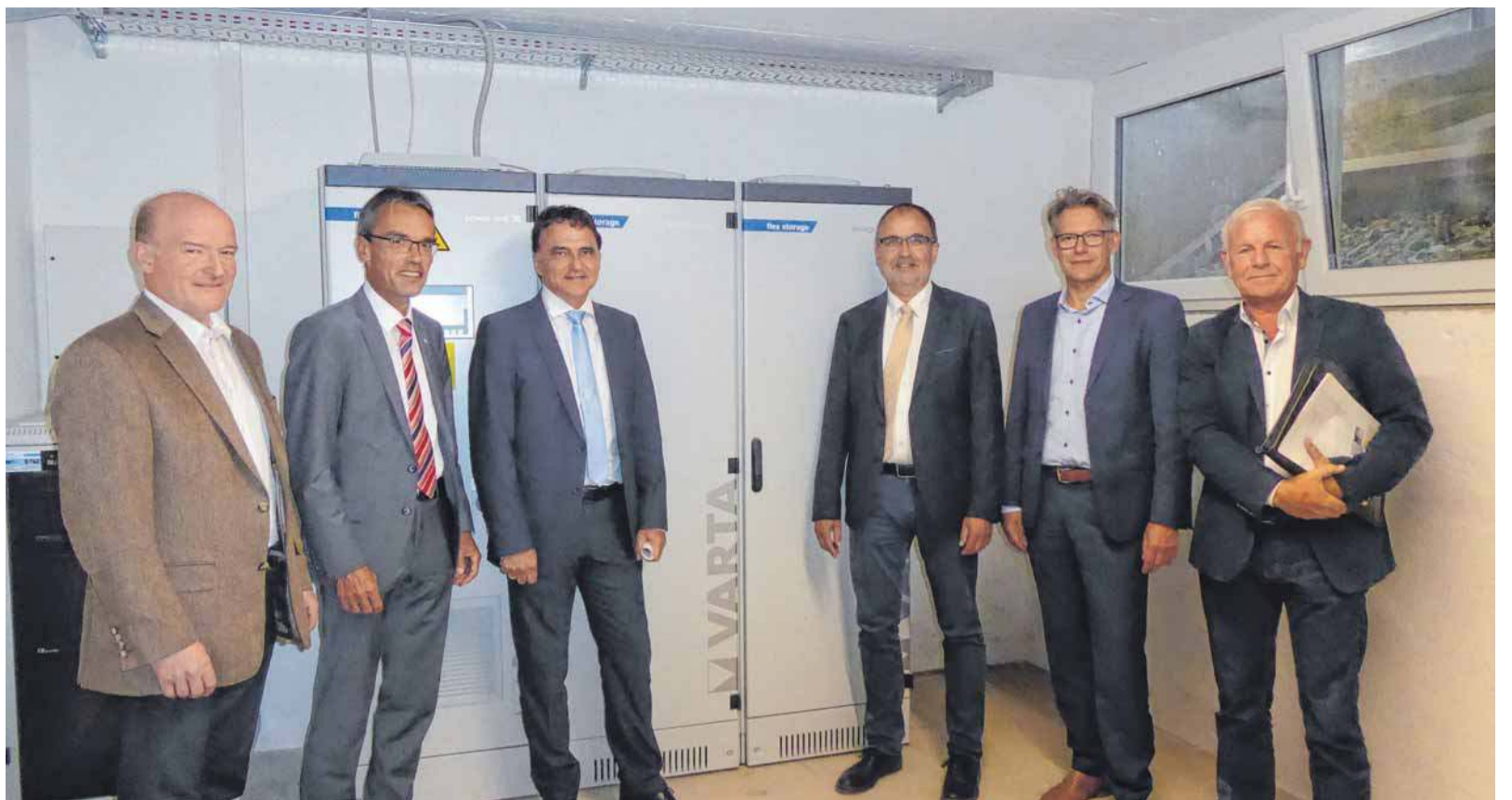
Ein Baustein des Erneuerbare-Energien-Konzepts in der Kastellschule Pfahlheim sind die Energiespeicher von Varta Storage im Keller. Sie sollen über 15 Jahre halten, hat Geschäftsführer Herbert Schein versichert. Von links: Ortsvorsteher Wolfgang Seckler, OB Karl Hilsenbek, Herbert Schein, Bürgermeister Volker Grab, Reiko Stutz von Varta Storage und Eduard Freiheit, der das gesamte Konzept geplant hat.
