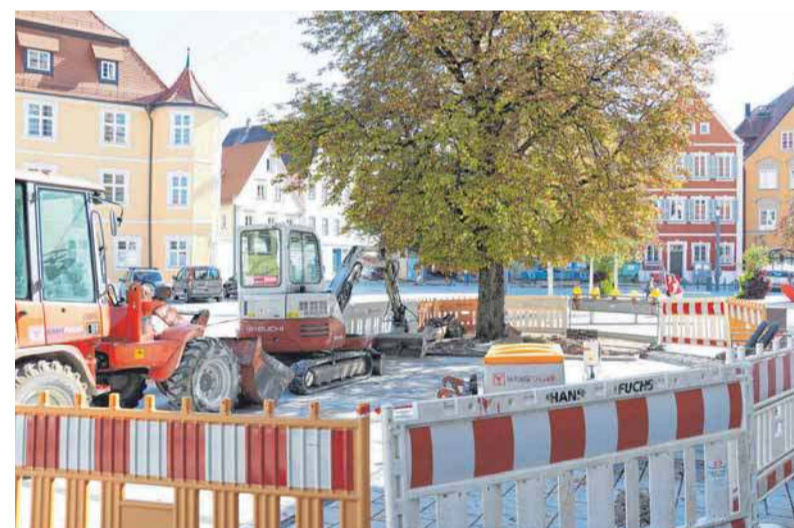
Am Marktplatz laufen die Bauarbeiten für die Stromtankstelle. Nächste Woche soll sie fertig sein.
